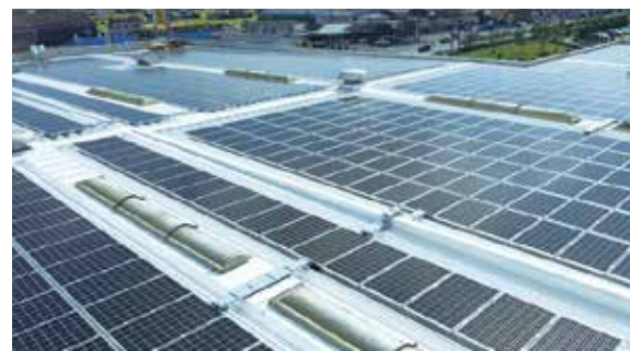
藤田本部のソーラーパネル(岡山市南区)
